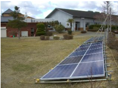
▲太陽光5.2kwから蓄電池へ電源を供給。自家発電設備になります。
